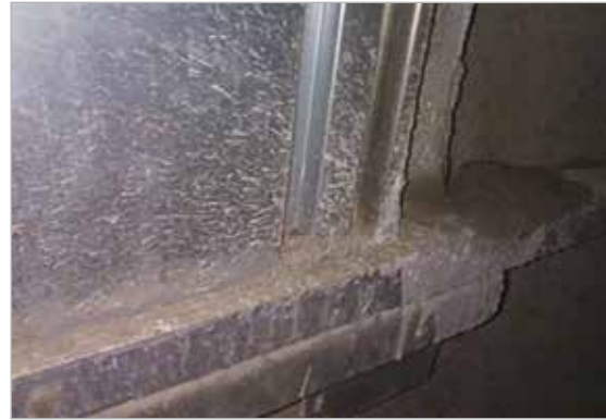
Slurry on the door sills
